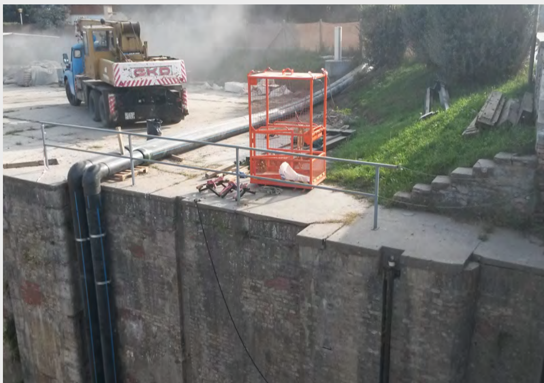
A Ferenc-tápcsatornán a vízpótlás céljából és jelentkező vízigények kielégítésére két darab, a műtárgyat megkerülő 300 mm átmérőjű KPE csőből és két darab 150 l/s vízhozamú Flygt búvárszivattyú telepítésével és üzemelésével került sor.
